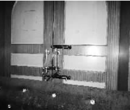
火锅店“安全通道”的大门紧锁,不能打开。
