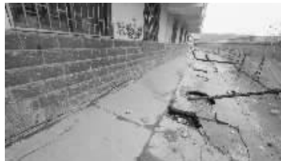
地基塌陷。本报首席记者 裴强 摄
