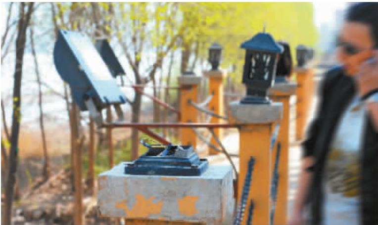
4月8日,记者看到水车博览园的水车旁大量的景观灯被人破坏,灯罩与基座上的螺丝全被人卸走,里面多根电线被剪断,部分电子元件不知去向,让人痛心。本报首席记者 裴强 摄
